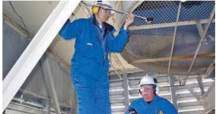
FIG. 5 Il peut être difficile de déterminer le débit d'air d'un ventilateur sans aide externe.
